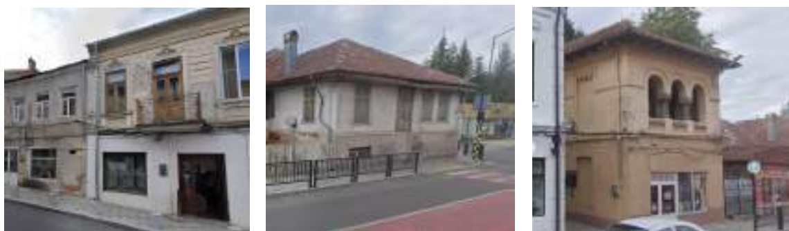
Fig.08 – Țesut construit degradat
